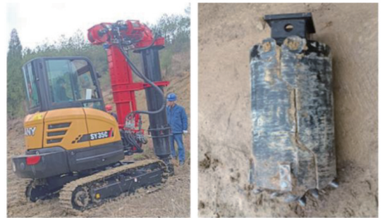
(a) 山地模块化微型钻机施工场景 (b) 施工时所使用的体开斗钻具
