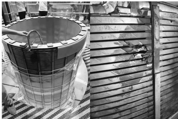
图 5 返厂检查确认高压 A 相绕组匝间短路
