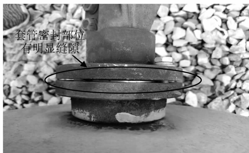
图 1 高压 A 相套管密封部位有缝隙
