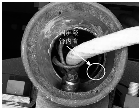
图 2 A 相套管出线铜屏蔽管内有明显的电弧烧蚀产物
