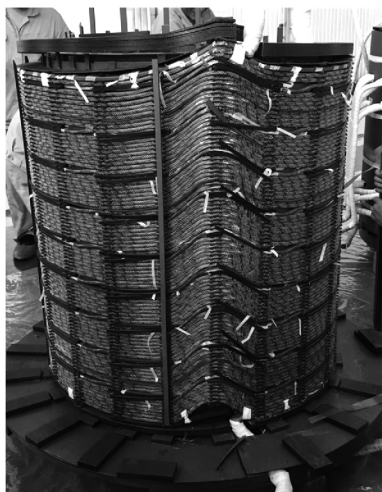
图4 变压器B相中压线圈轴向变形情况
