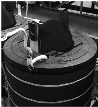
图3 变压器B相绝缘压板破损情况
