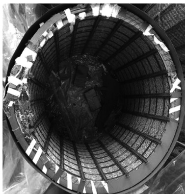
图5 变压器B相中压线圈辐向内收情况
