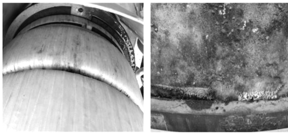
图1 互感器舱室内部积水及发霉情况
