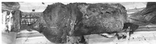
图1 甲线3号电缆接头B相烧损严重
