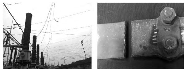
图 1 断裂的 PT 引流线夹
