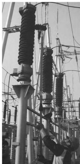
图2 220 kV 变电站试验
