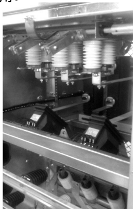
图 3 XGN2-40.5kV 型高压开关柜试验平台
