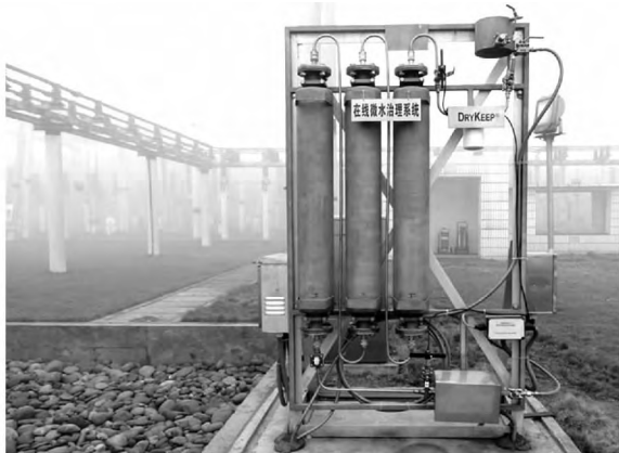
图3 微水在线控制系统现场图
