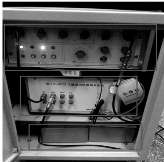
图7 电介质响应现场测试系统
