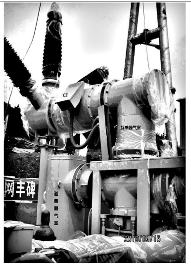
图 1 GIS 出线间隔实物图
